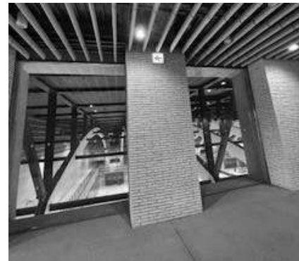
写真 24 上にある避難灯
